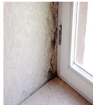
Posledice nekakovostne vgradnje okna.
